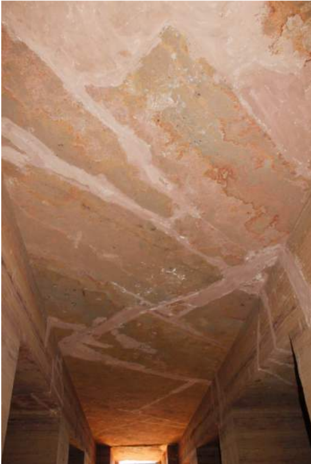
Fig. 6.18. Fracturas y grietas en la nave central de la sala hipóstila de QH31 (Sarenput II). Autor: F. Martínez Hermoso © Proyecto Qubbet el-Hawa (campana 2014).
